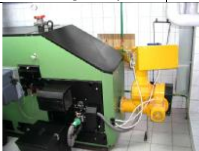
Rys. nr 3 Kocioł z automatycznym podajnikiem paliwa - Wrzeście.
