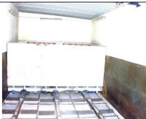
Rys. nr 4 Magazyn paliwa w kotłowni – „ruchoma podłoga”
